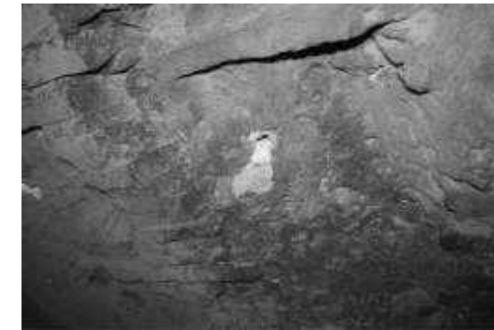
Buco persistente che mette in evidenza il materiale giallo associabile a tuffelli, quindi parte originale della volta in corrispondenza dell'arcone.
