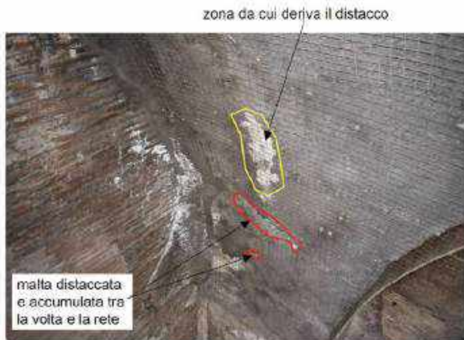
Figura 4.1.3.2 Malta già staccata e trattenuta dalla rete metallica di intradosso
