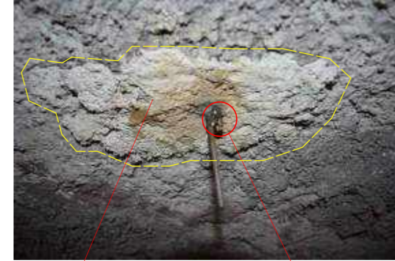
malta di sigillatura del foro con processo di degrado dovuto all'ossidazione del ferro
