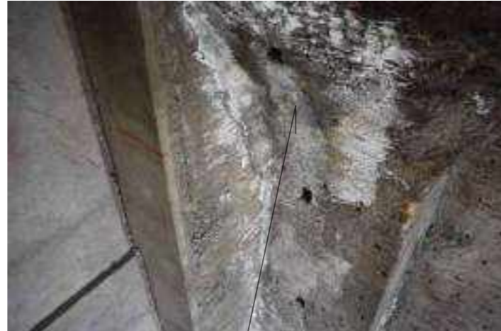
Intonaco originale della volta in stato di degrado avanzato con manifestazione di efflorescenze
