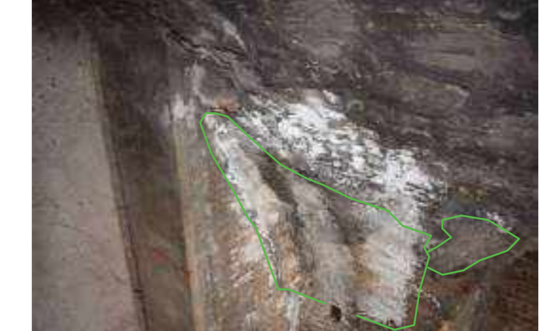
Visibile intonaco originale della volta
