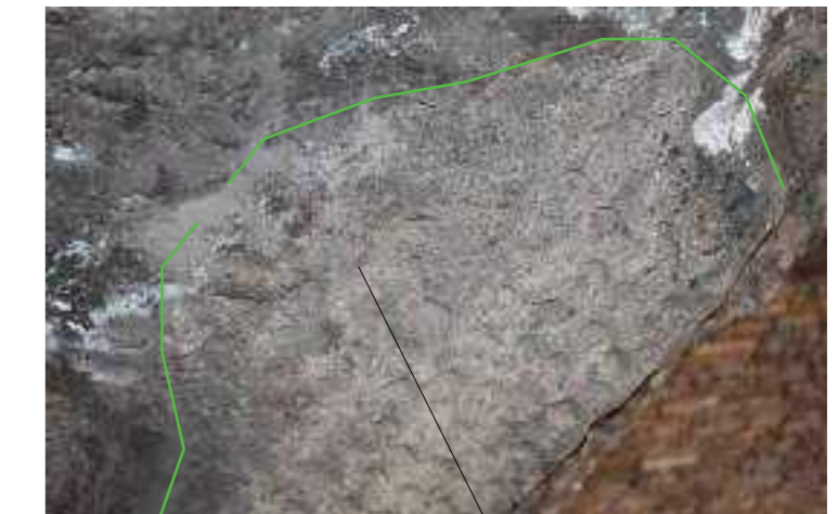
Prelievo del campione A3 in corrispondenza dell'intonaco originale
