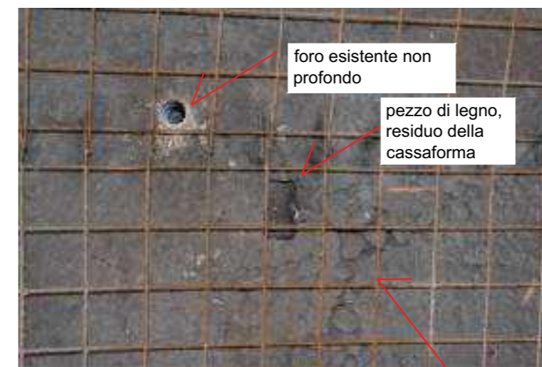
Visibili vespai all'intradosso della volta in CA
