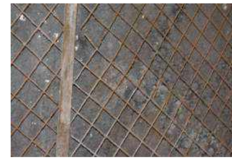
Visibili vespai all'intradosso della volta in CA
