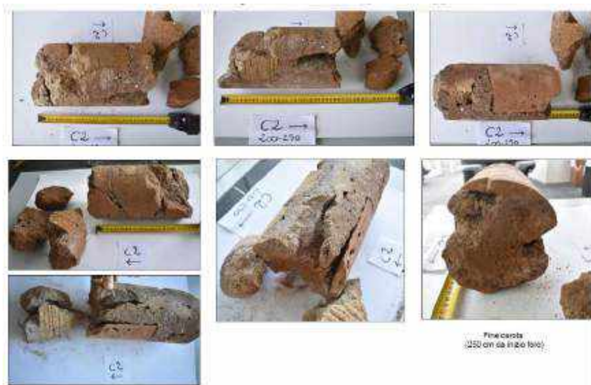
Figura 4.3.1.8 Dettaglio interno alla struttura del pilastro 2, visibile grazie al carotaggio C2. L'umidità è diffusa e la qualità dei caementa è variabile per tipo, dimensioni e geometria. Numerose sono le discontinuità tra malta e caementa, ben visibili sul campione estratto e poco nella videoendoscopia eseguita all'interno del foro.
