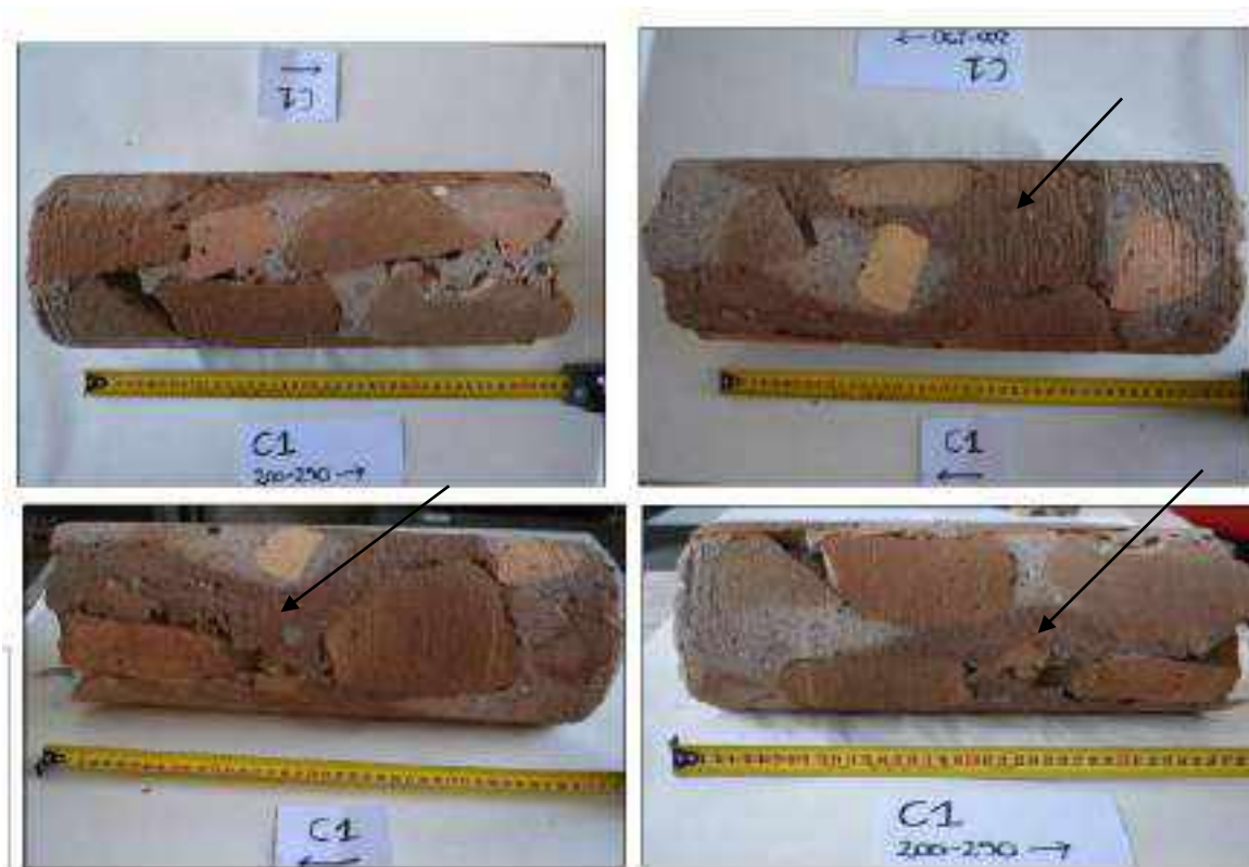
Figura 4.3.1.7 Dettaglio interno alla struttura del pilastro 1, visibile grazie al carotaggio C1. Le zone indicate con la freccia sono ancora umide a distanza di 28 giorni dalla estrazione.
