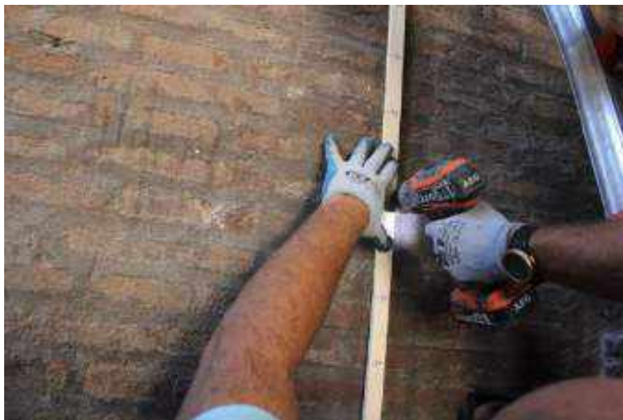
Figura 3.3.1.3 – Fase di materializzazione dei punti sul paramento per la realizzazione dei microfori
